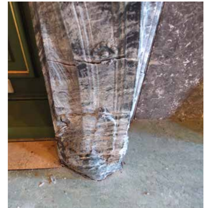
De linkerwang in detail. Scheurvorming in en verbrotting van het marmer zijn duidelijk te zien.
